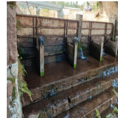
闸门下游现状，闸门漏水严重
